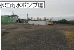
水江雨水ポンプ場
