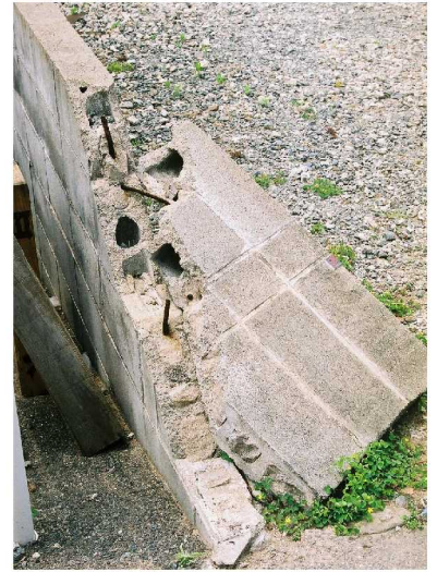
塀の端部は損傷しやすいため、端部の鉄筋が重要である
