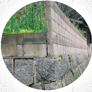
擁壁上のブロック塀 の危険性
