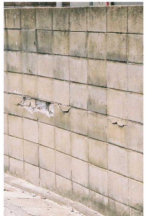
横筋が腐食・体積膨張し、ブロックを損傷している危険な塀
