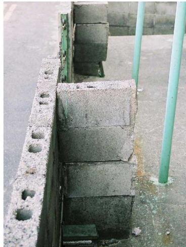
塀と一体に施工されていないため、地震で損傷を受け、役目を果たせなかった控壁
