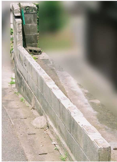
たて筋等が施工されておらず、粘ることなく倒れた塀
