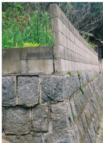
石造の擁壁の直上に基礎なしで設けられた塀。地震により上部が傾き危険な状態である
